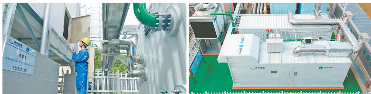
煤氣公司一直致力推動能源技術創新。深燃大廈綜合能源項目是集團屬下港華能源第一個以燃氣分布式能源為主，綜合光伏及儲能，提供多能源穩定安全供應的「源網荷儲」一體化能源互聯網示範項目。
